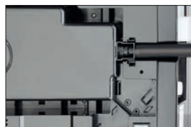
Collegamento idraulico fisso
